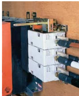
Fig. 3 Cable con. sideways
